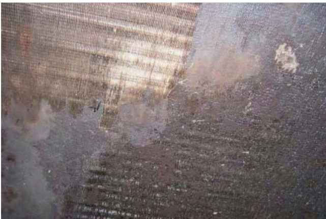
Abb. 1: Verschmutzter Verflüssiger, die Lamellen verschließen sich langsam.
