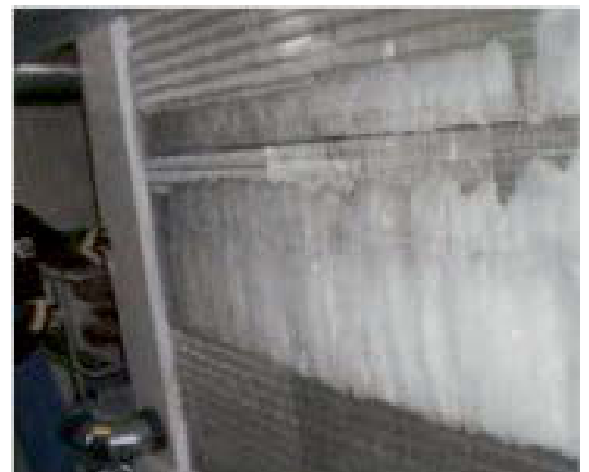
Abb. 3: Vereister Verdampfer. Nur noch ein Teil der Fläche wird von Luft durchströmt.
