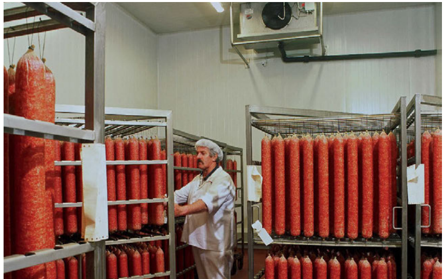
Kühler in einem Wurstreiferaum
