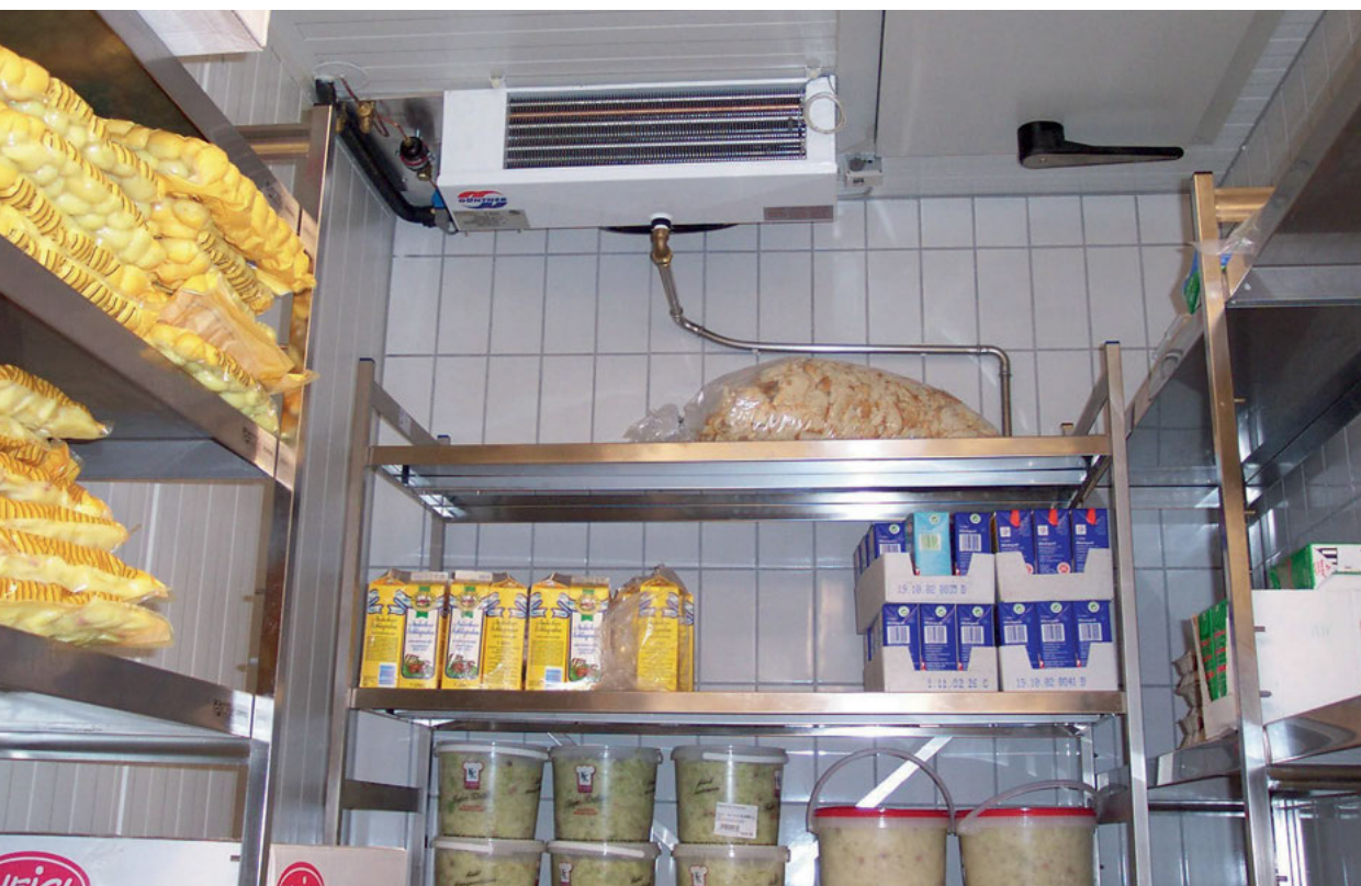
Pluskühlraum mit Deckenluftkühler zur Vergrößerung der Stapelhöhe
