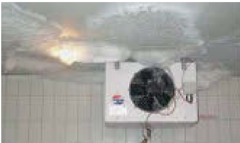
Vereisungen an Decke und Wand
